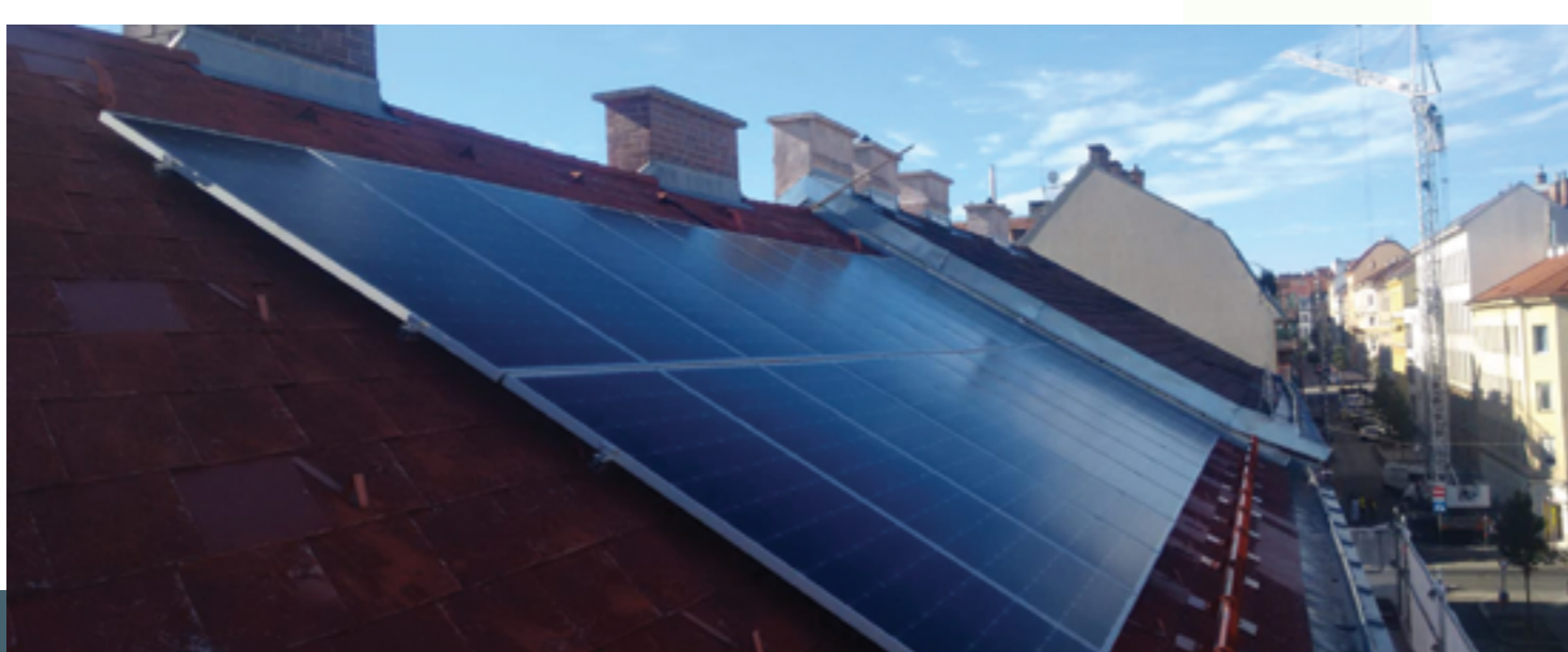
Bild © raymann kraft der sonne photovoltaikanlagen gmbh
